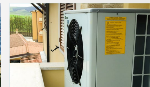
Impianto Pompa di Calore per Raffrescamento e Riscaldamento
