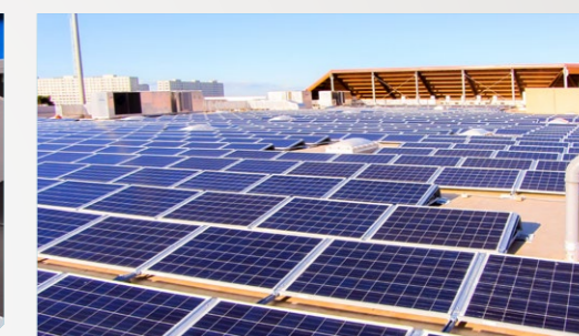
Impianto Fotovoltaico da 350 kWe
